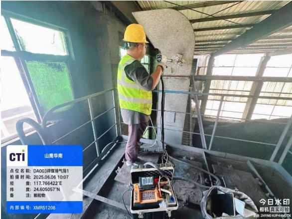
DA003 碎煤排气筒 1
