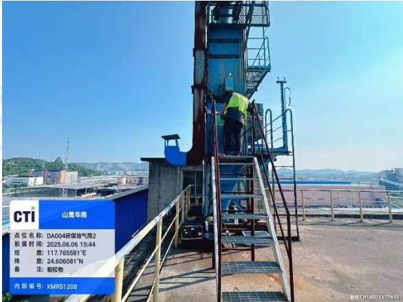
DA004 碎煤排气筒 2
